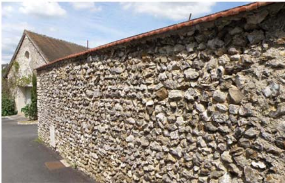
Mur de maçonnerie de moellons hétérogène - destiné à être enduit et laissé apparent - sans protection contre les intempéries, il va se dégrader et accrocher notamment des éléments de mousses et autres organismes.
